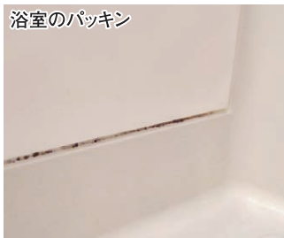
浴室のパッキン
